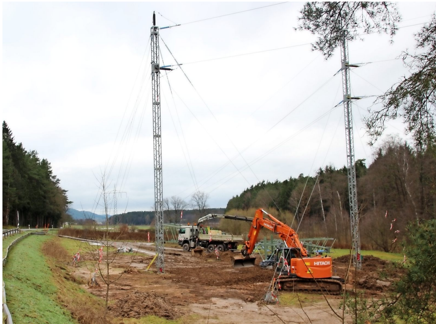
Auf dem Weg von Burgstall nach Mitwitz sind die Bauarbeiten rechts der Straße nicht zu übersehen.
