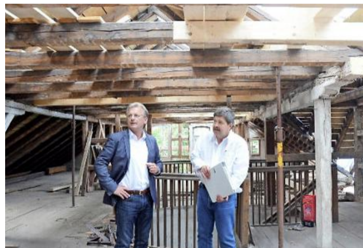
Im Dachgeschoss werden die Trennwände entfernt und die Dämmebene bis zum First hochgezogen. Damit eignet es sich für leichte Archivgegenstände und Ausstellungen.
