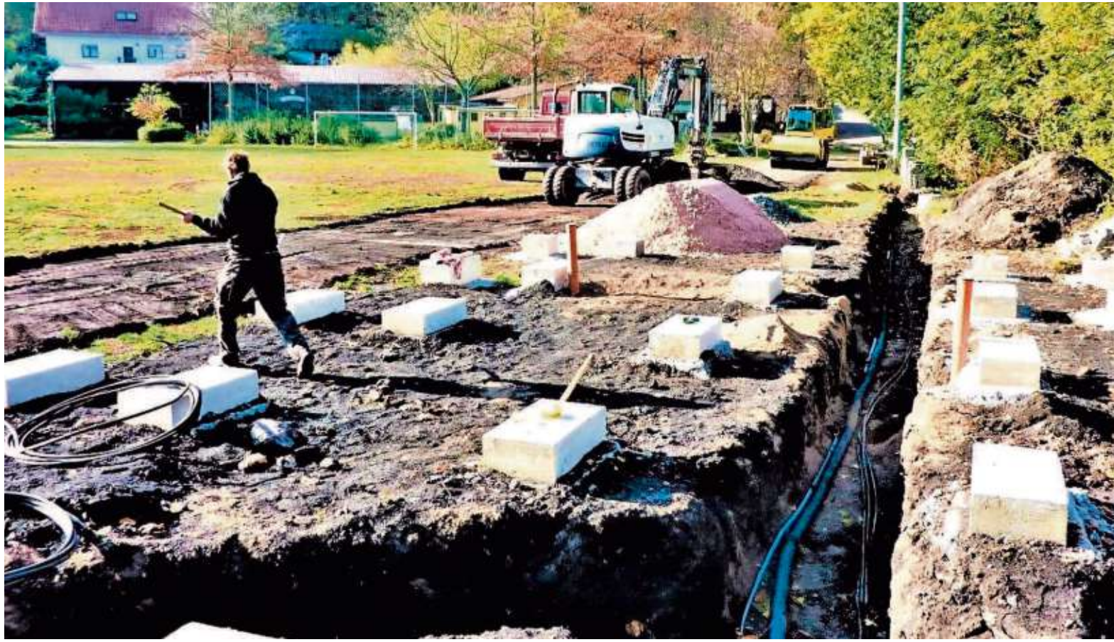
Im Nordbereich des Maxschacht-Sportplatzes werden Container, ausgestattet mit Duschen und WC-Anlagen, installiert.
